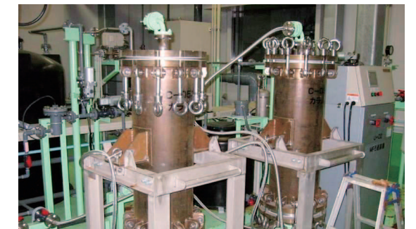
海水リチウム回収プラント（吸着カラム）
