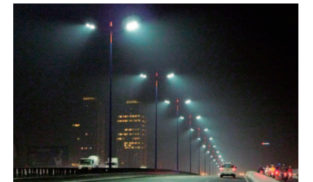
ベトナム・第2サイゴン橋に設置された道路灯LED照明
