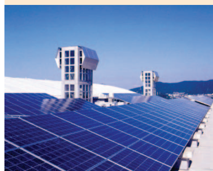
太陽電池(最大出力150kw)
