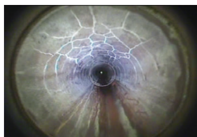
◀下水道管の検査画像
