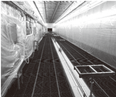
大型樹脂製品塗装ライン
