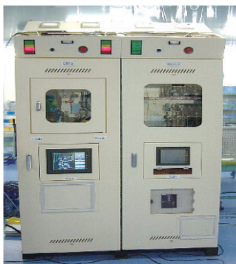
ガス希釈供給設備
