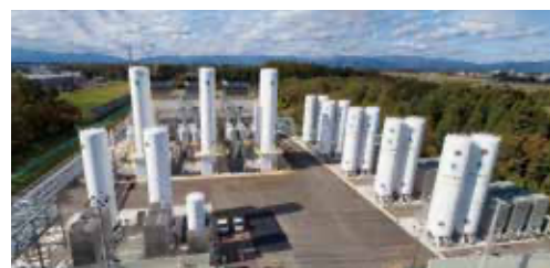
お客様の隣接地に設置されたトータル・ガスセンター
