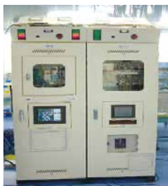
ガス希釈供給設備
