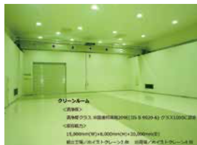
クリーンルーム内部
